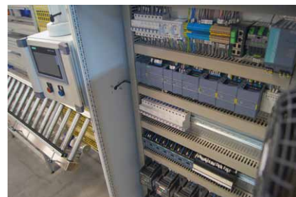
Szafa sterująca systemu transportowego
